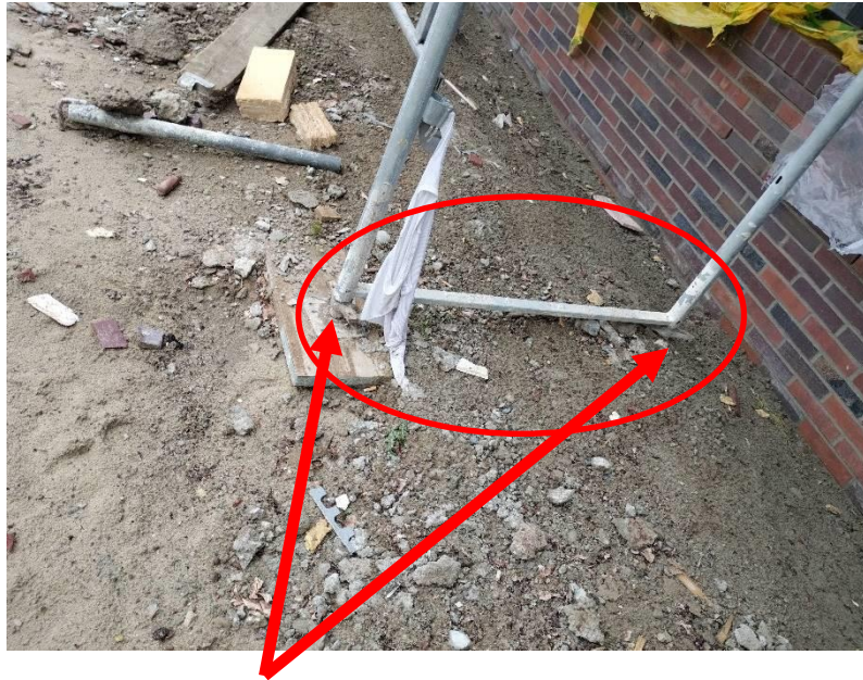
Gerüstfüße nicht ordnungsgemäß aufgestellt, lastverteilende Beläge nicht in Ordnung bzw. nicht vorhanden
