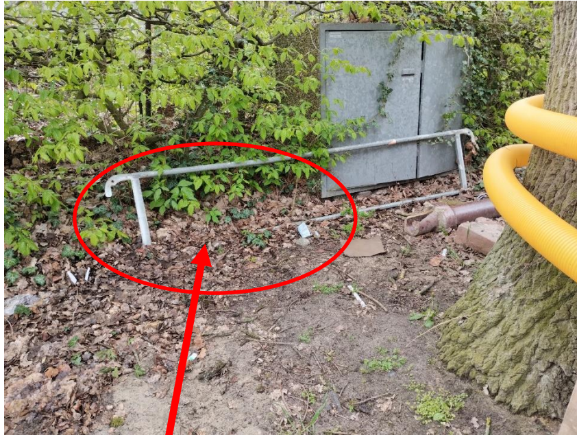
Nicht unmittelbar wieder eingesetzter Seitenschutz
