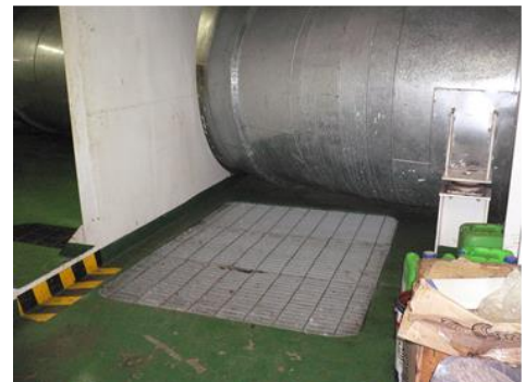
Abb. 9: Maschinenraum und Schott
